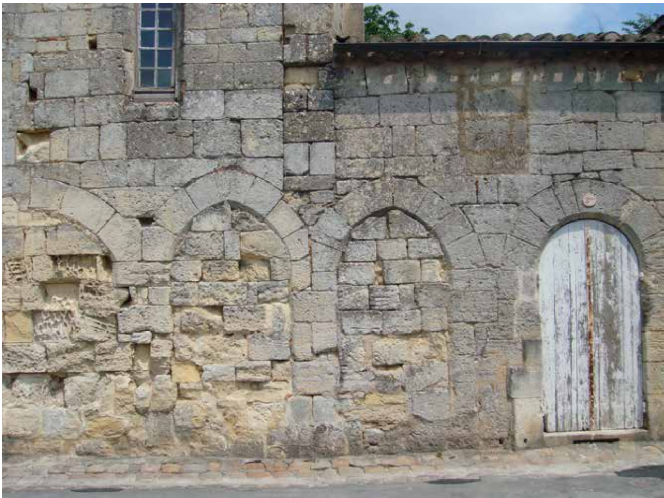
▲ Fig. 2. – Façade gothique avant restauration. © Architecture Patrimoine.
